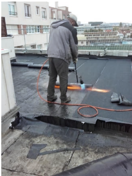
> Résidence Jules Ferry : réfection de l'isolation et de l'étanchéité de la toiture-terrasse
