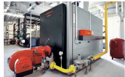
> Rue de la Tour, nouvelles chaudières
